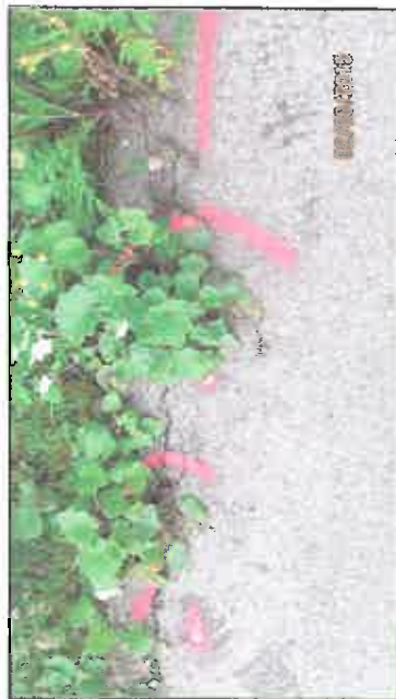
Abb. Pflanzendurchwuchs im Asphalt
