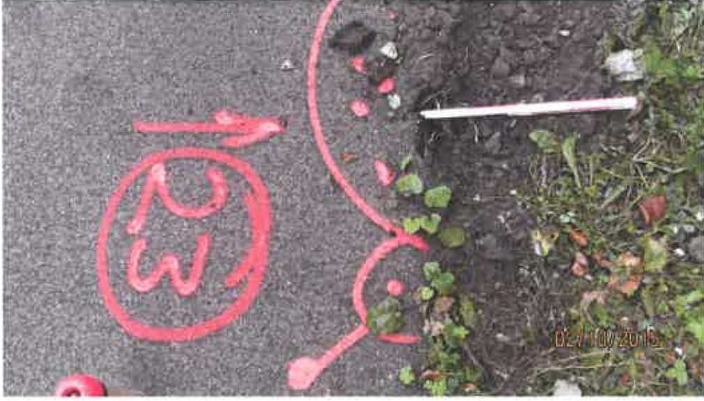
Punkt 23 = 7cm (Wurzeleinwuchs)
