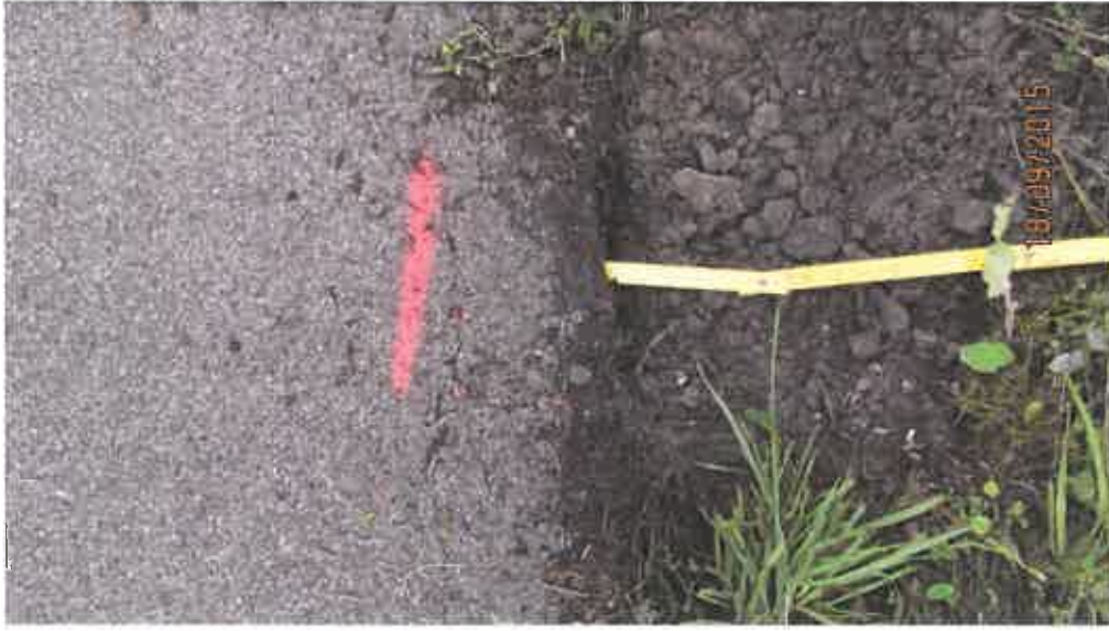
Punkt 19 = 9cm (Risse)
