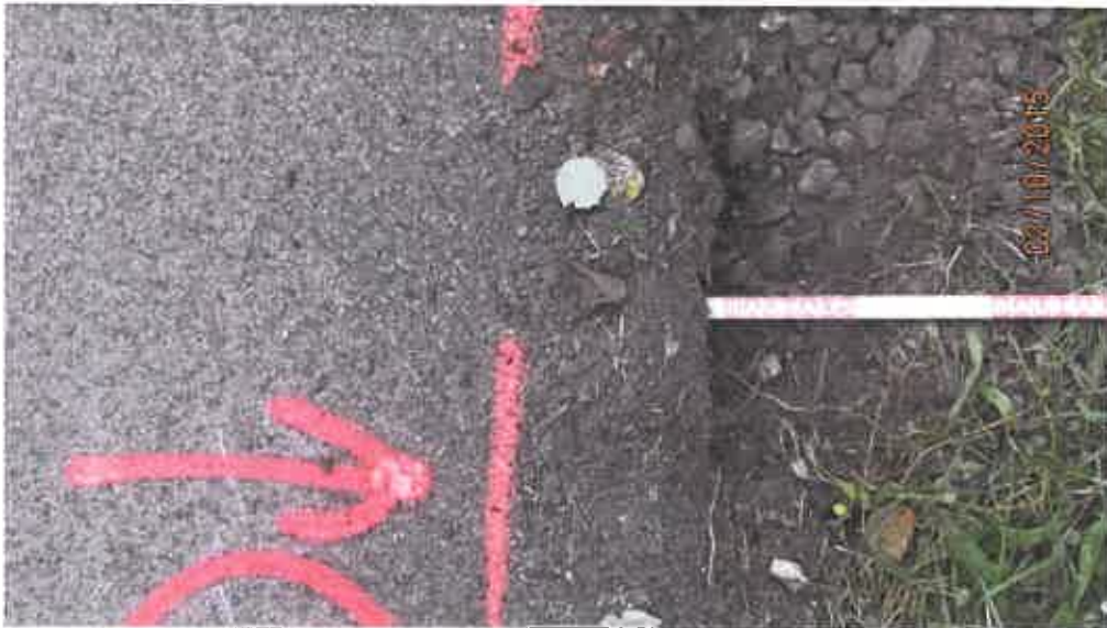
Punkt 24 = 9cm (Risse)
