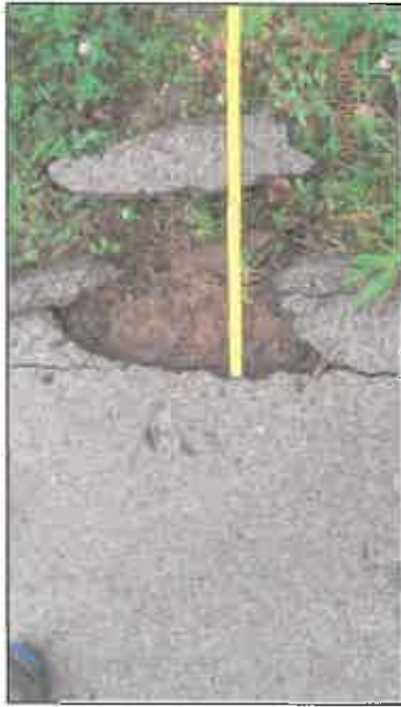
Abb.: Bsp. 1,6cm fehlende Tragschicht unter der Deckschicht
