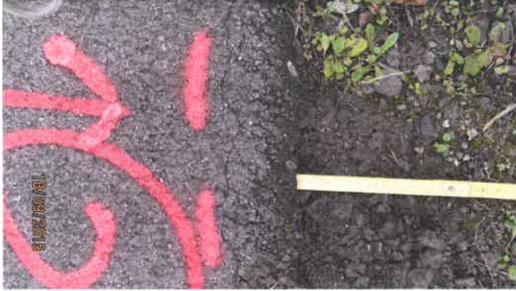
Punkt 22 = 4cm (Risse)
