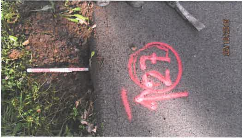
Punkt 27 = 9cm (Risse)
