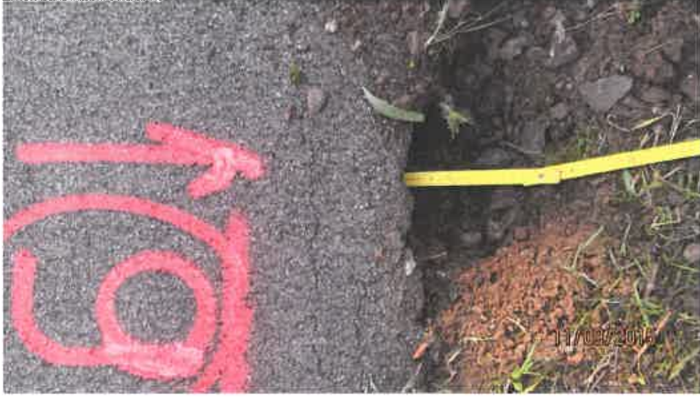
Punkt 9 = 9cm (Risse)
