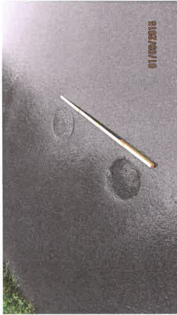
Bsp: Kernbohrungen nicht Deckengleich eingebaut
