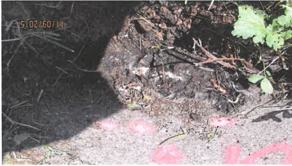
Punkt 10 = 0cm (Wurzeleinwuchs)
