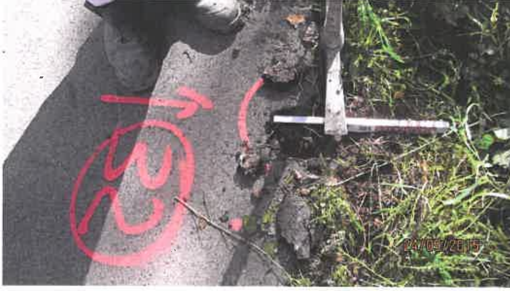
Punkt 32 = 15cm (Wurzeleinwuchs)
