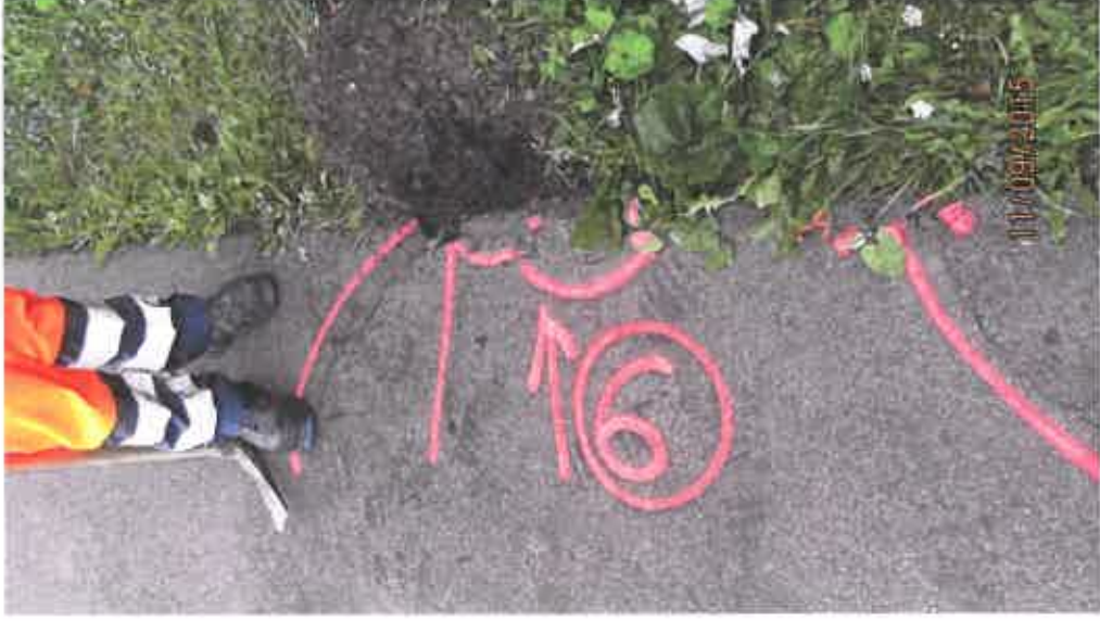
Punkt 6 = 0cm (Wurzeleinwuchs)
