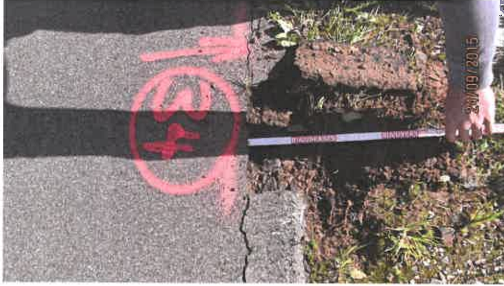
Punkt 34 = 13cm (Risse)
