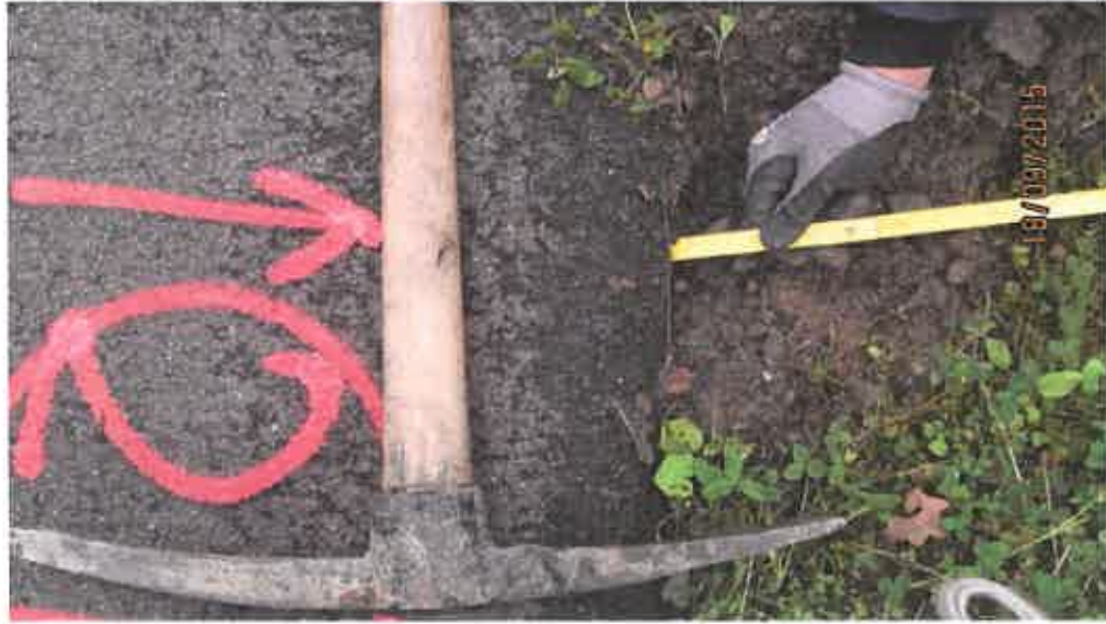
Punkt 21 = 8cm (Risse)
