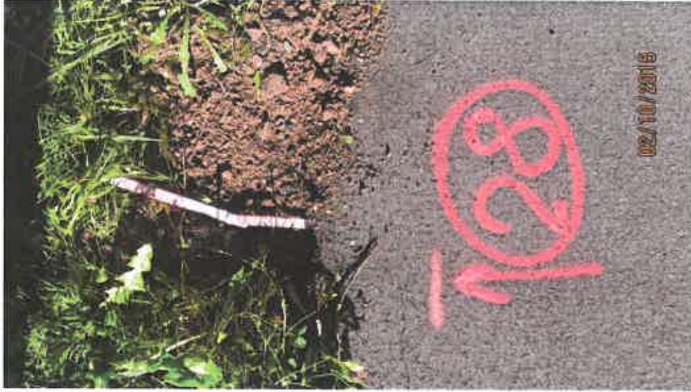
Punkt 28 = 7cm (Risse)
