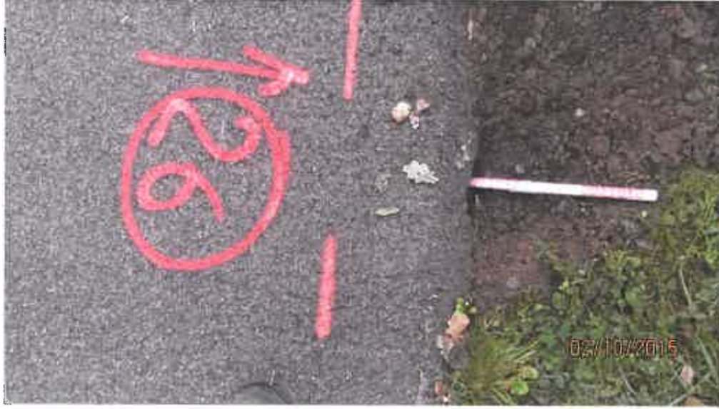
Punkt 26 = 13cm (Risse)
