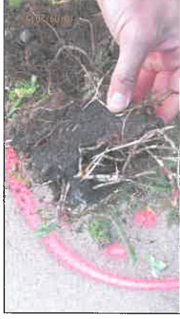
Abb: Wurzeldurchwuchs zwischen Trag- und Deckschicht
