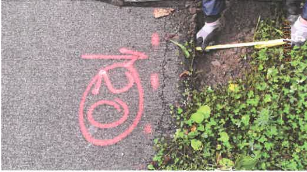
Punkt 20 = 14cm (Risse)
