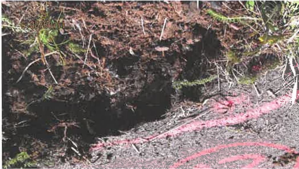
Punkt 13 = 3cm (Wurzeleinwuchs)
