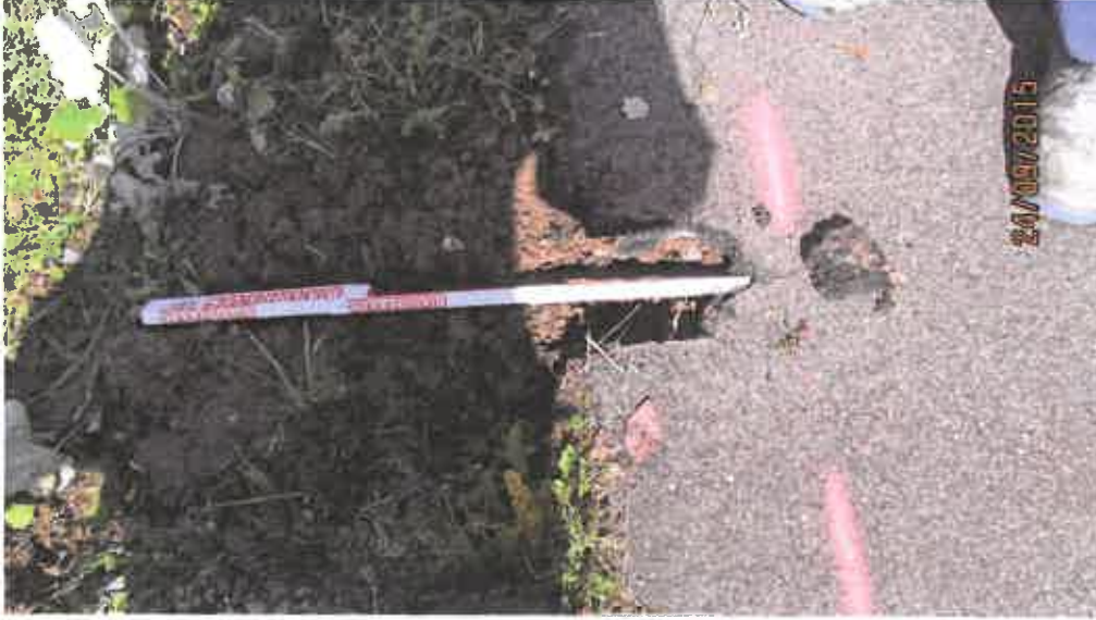
Punkt 31 = 20cm (Risse)
