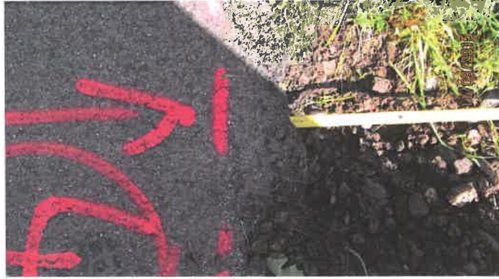
Punkt 4 = 7-8cm (Risse)
