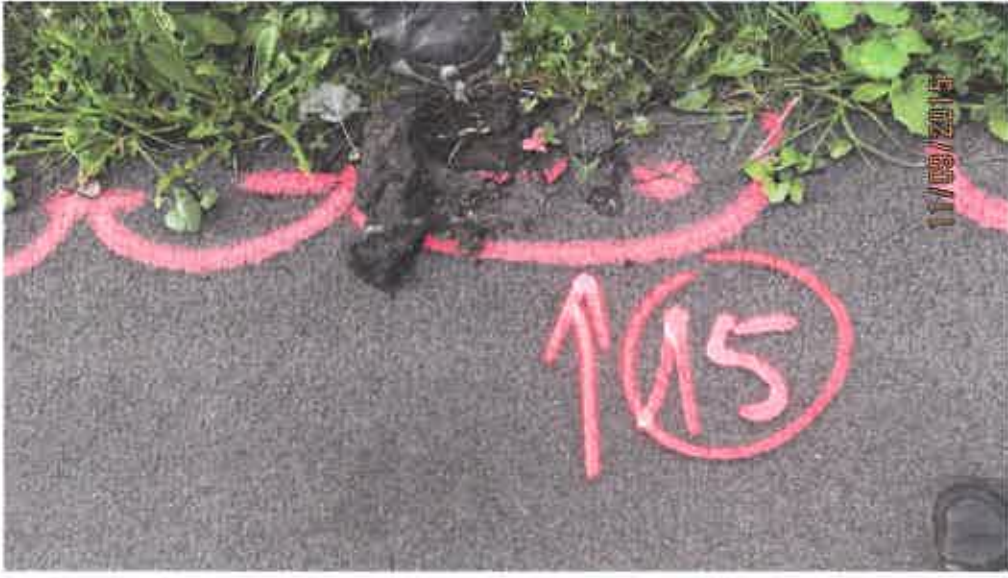
Punkt 15 = 9cm (Wurzeleinwuchs)
