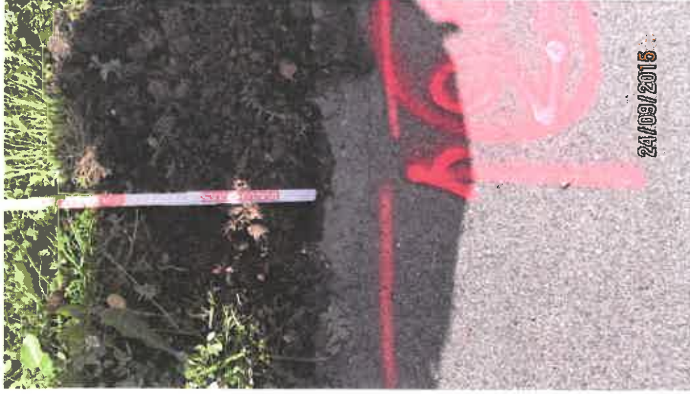
Punkt 29 = 7cm (Risse)
