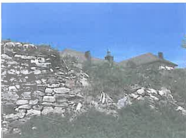
12. Schäden an der historischen Natursteinmauer südlich vom Kloster Reichenstein.
