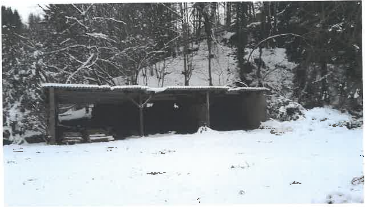
Baufälliges Nebengebäude / ehemaliger Überdachter KFZ – Stellplatz
